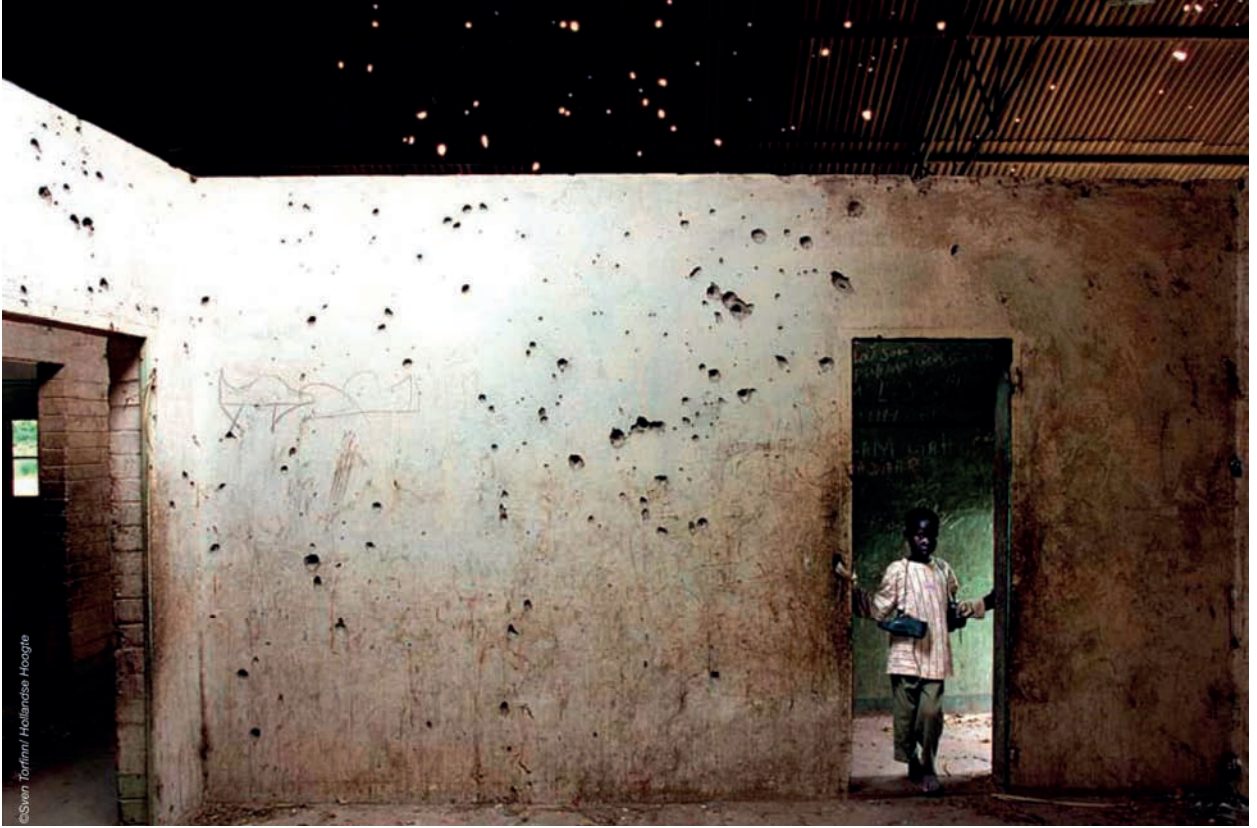
طفل في مبنى يظهر على واجهته آثار رصاص، في منطقة لير، نوفمبر ٢٠٠٢.
