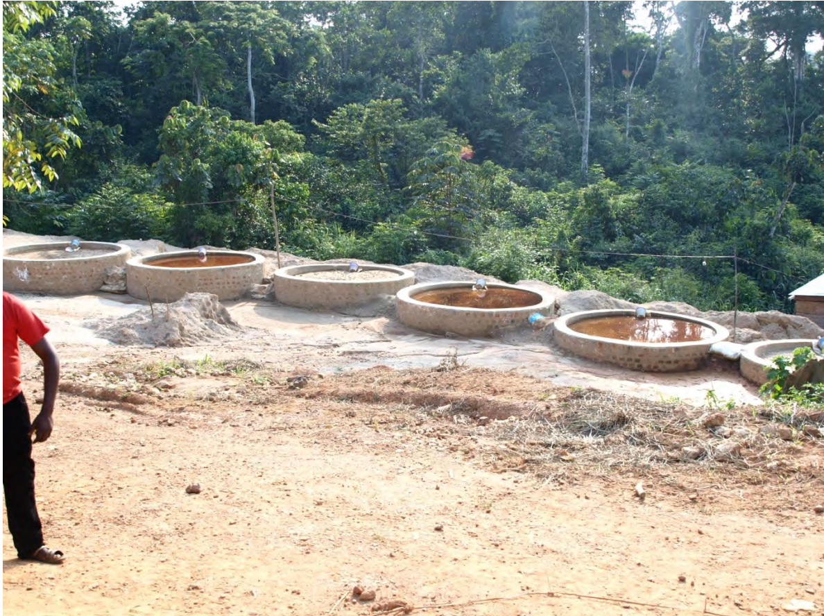
Les bassins pour le traitement des déchets sur le chantier de Mbuyi-Maji, dans le permis de Kilo Goldmines (Photo : Peer Schouten, 2014)
